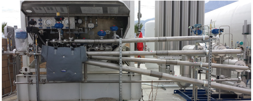
LNG Vacuum Insulated Lines
